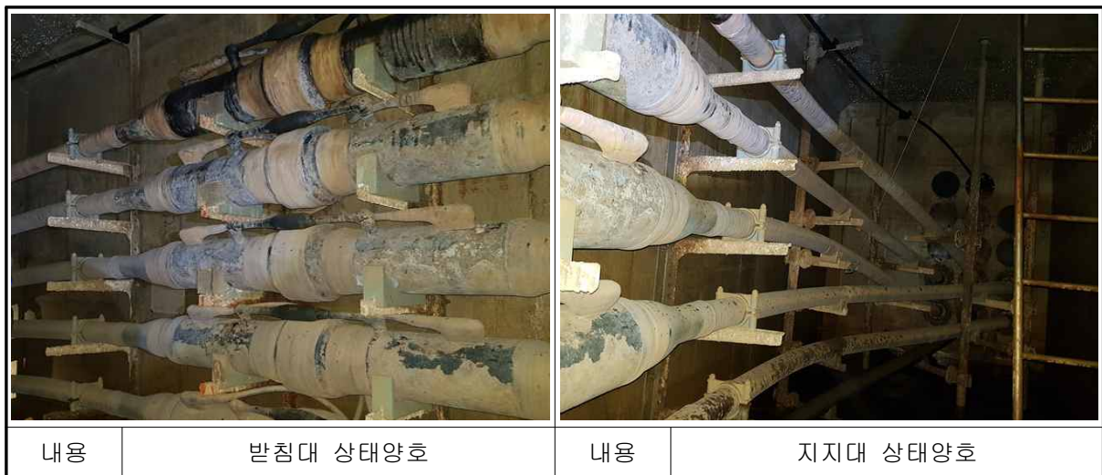
【사진 6.9】 부속 및 부대설비 현황
