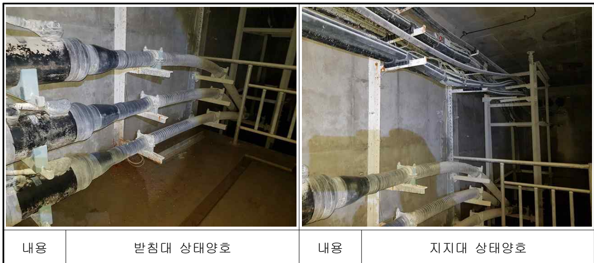
【사진 6.4】 부속 설비 현황
